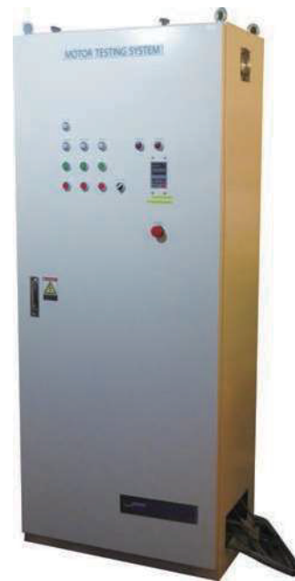
負荷モータ制御盤
